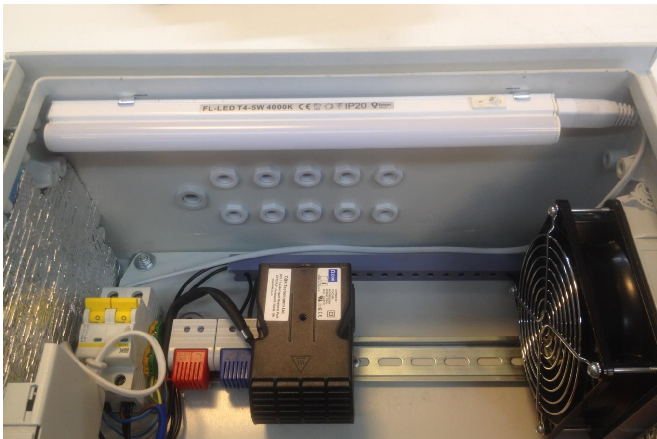
Рис.3.2.3-1 Светильник, установленный в пружинные крепления шкафа OSP.
